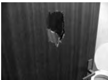
proražené dveře na WC
