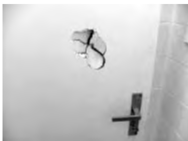
proražené dveře na WC
